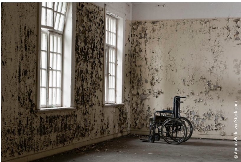
Fauteuil roulant dans un bâtiment délabré.
